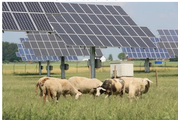
Rysunek 6 Zastosowanie rozwiązania agrofotowoltaiki w ramach farmy fotowoltaicznej Untermöckenlohe
